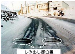
しみ出し部手前は圧雪路面に対し、しみ出し部より約200m先まで路面露出。
